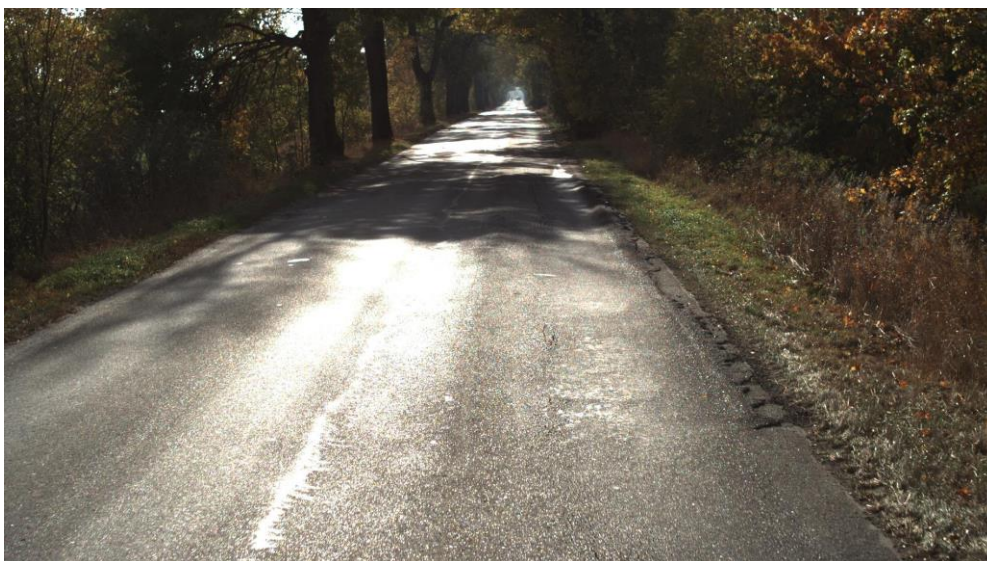
Rysunek 12: Stan ostrzegawczy: uszkodzenia krawędzi oraz widoczne koleiny
