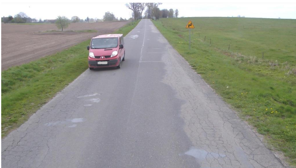
Rysunek 13: Stan zły: spękania siatkowe i skupiska spękań zajmujące ponad 30% powierzchni
