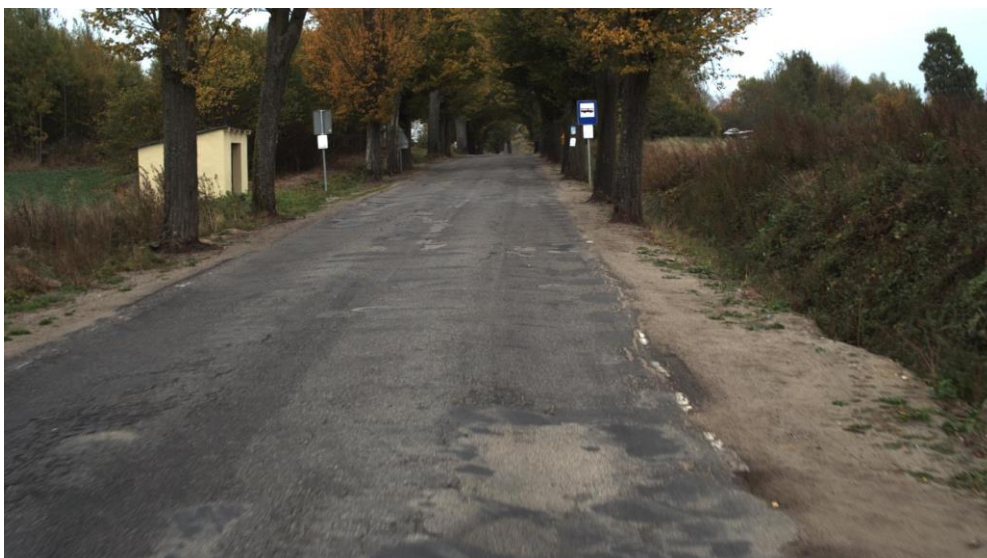
Rysunek 16: Stan zły: liczne uszkodzenia, nawierzchnia mocno skoleinowana
