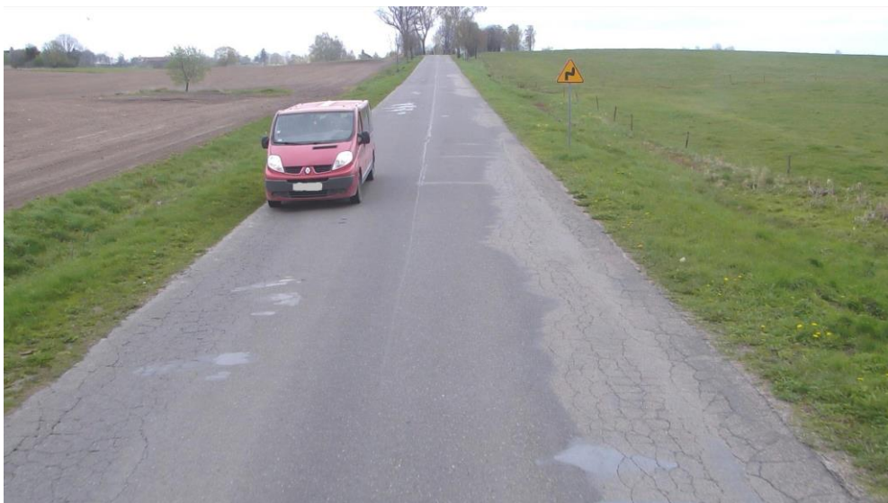
Rysunek 15: Stan zły: spękania siatkowe i skupiska spękań zajmujące ponad 30% powierzchni
