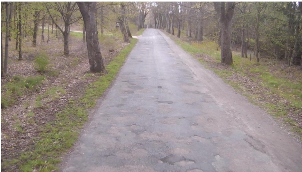
Rysunek 17: Stan zły: liczne uszkodzenia. Nawierzchnia zdegradowana
