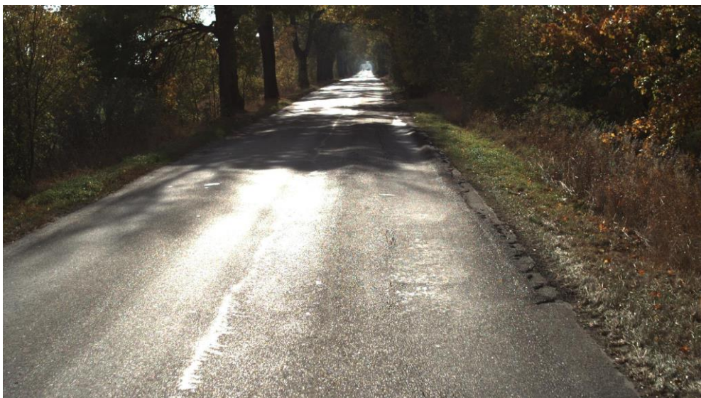
Rysunek 14: Stan ostrzegawczy: uszkodzenia krawędzi oraz widoczne koleiny
