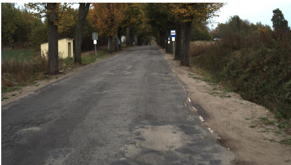
Rysunek 18: Stan zły: liczne uszkodzenia. Nawierzchnia mocno skoleinowana
