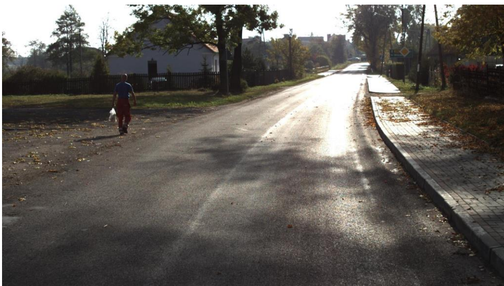
Rysunek 10: Stan ostrzegawczy: brak uszkodzeń powierzchniowych, widoczna nierówność w śladzie prawego koła
