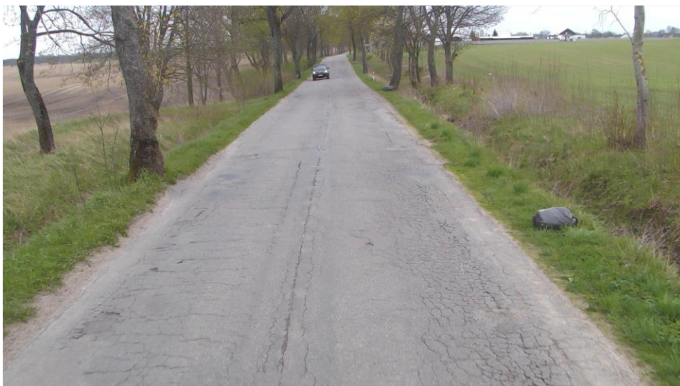
Rysunek 16: Stan zły: spękania siatkowe zajmujące ponad 30% powierzchni
