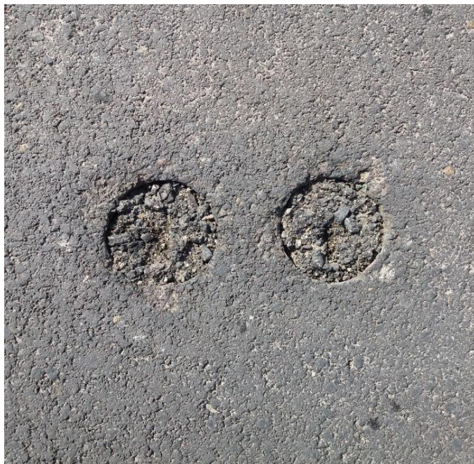
Przykład 8: Nieprawidłowo zabezpieczone miejsce wykonania odwiertu, niedostateczna ilość masy wypełniającej
