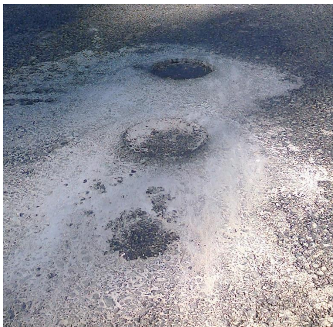
Przykład 9: Nieprawidłowo zabezpieczone miejsce wykonania odwiertu, niedostateczna ilość masy wypełniającej
