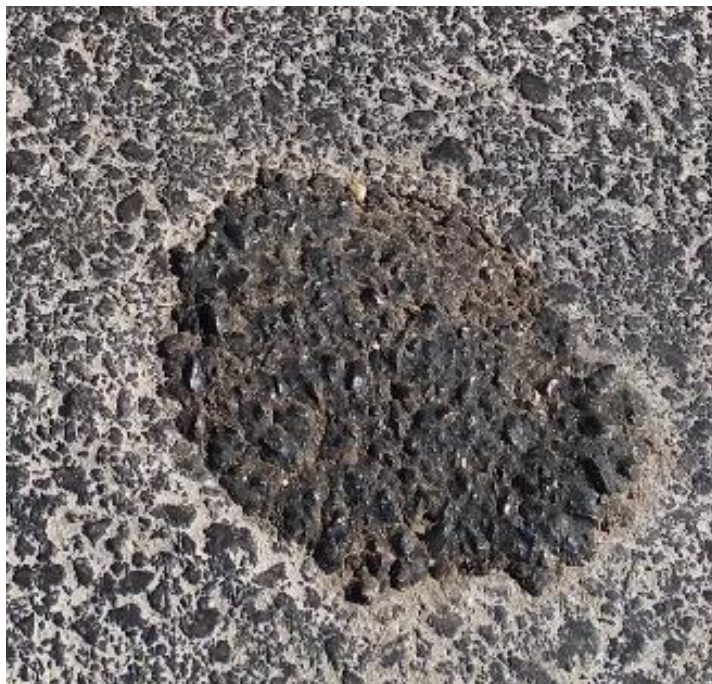
Przykład 6: Nieprawidłowo zabezpieczone miejsce wykonania odwiertu, nadmiar masy wypełniającej
