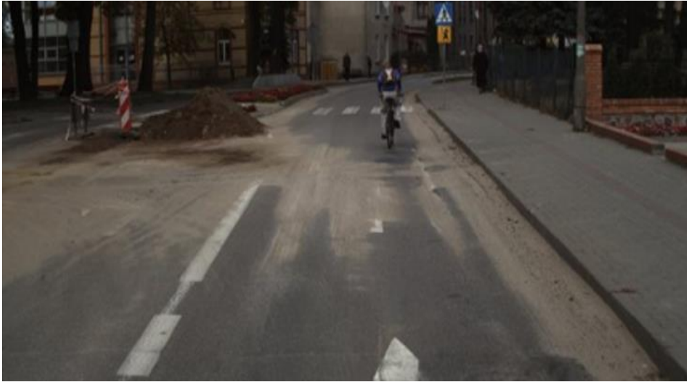
Przykład 13: Zabrudzenie nawierzchni (kruszywo, piasek)
