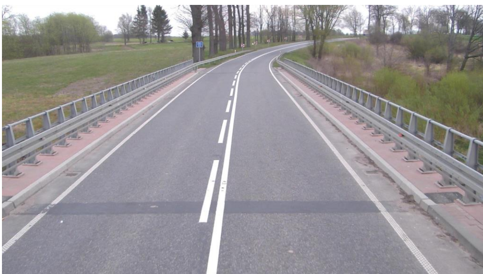
Przykład 2: Zmiany asfaltu związane z konstrukcją obiektów mostowych zidentyfikowane jako łaty
