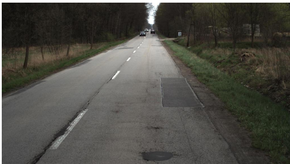
Przykład 4: Niezakodowane nieszczelne spojenia technologiczne na krawężniach łat wbudowanych
